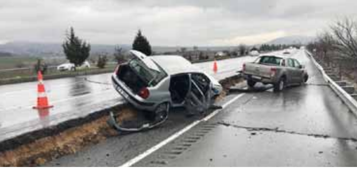
Deprem nedeniyle Kahramanmaraş ile Pazarcık ilçesiarasındaki yolda hasar meydana geldi.
